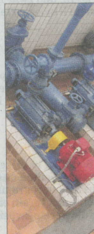
Netzpumpen sorgen für den richtigen Druck.
